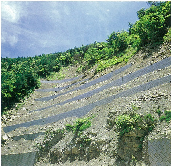
鷹の巣 昭和55年度 大滝村大滝 コンクリートブロック土留工 施工中
