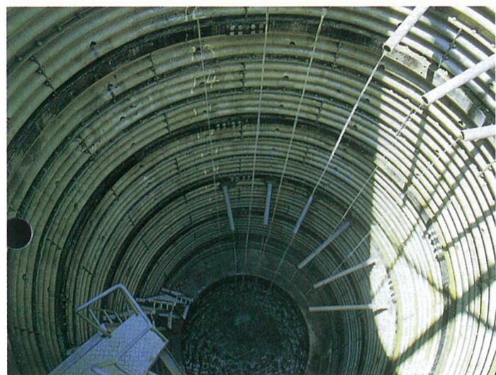
集水井 (皆野町)
