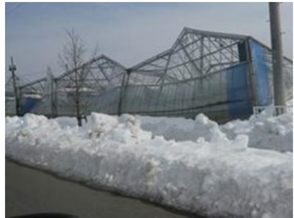
写真 2.2 農業用施設の被害状況
