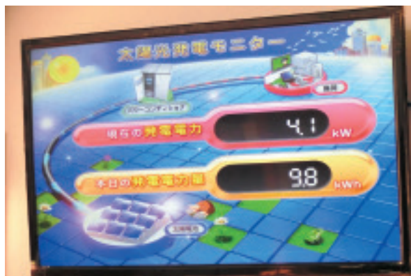
写真3-13-3 太陽光発電のモニター
