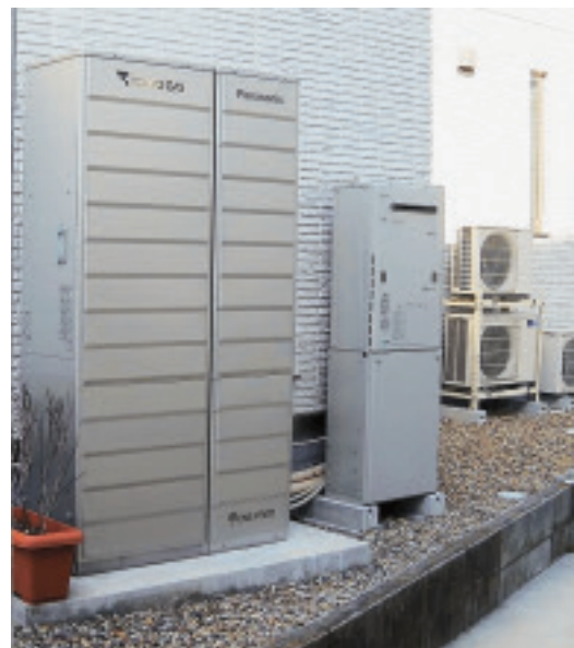
写真3-13-5 住宅に設置されたエネファーム
