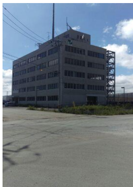
(被災した合同庁舎)
