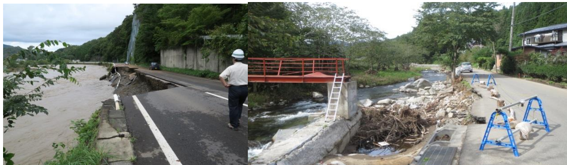
台風 10 号による被害箇所
