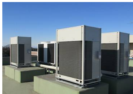
空調設備の高効率化
