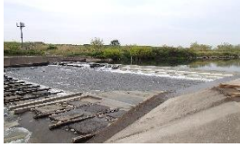
② 菅間頭首工
