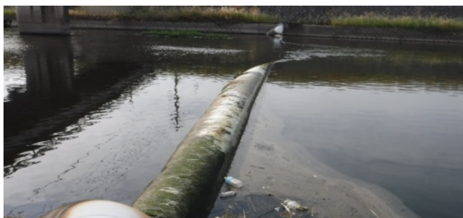
▲施工前：内部に水が入り完全に膨らまない袋体
