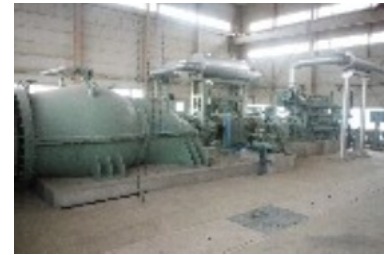
奈良川排水機場 ポンプ・原動機
