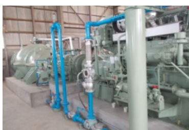
ポンプ・原動機
