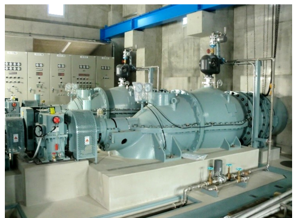
排水ポンプ φ1000×2台
