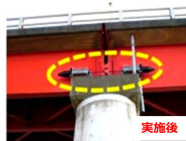
橋桁落下防止のためのPCケーブルによる橋桁どうしの連結
