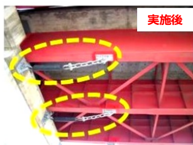
橋桁落下防止のための緩衝チェーンによる橋台・橋脚との連結
