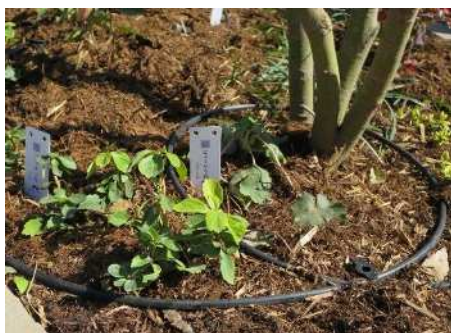
自動散水システム
