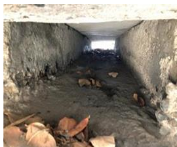
土砂が堆積した下水管
