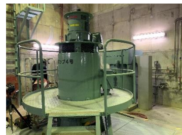
日進中継ポンプ場 ポンプ設備
