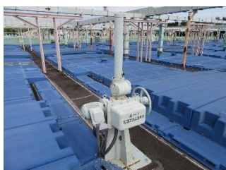
荒川水循環センター 水処理設備
