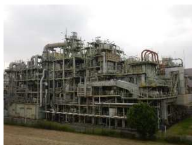
荒川水循環センター 汚泥焼却炉
