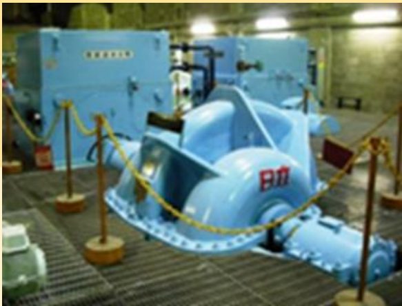
大久保浄水場 送水ポンプ（回転数制御）
