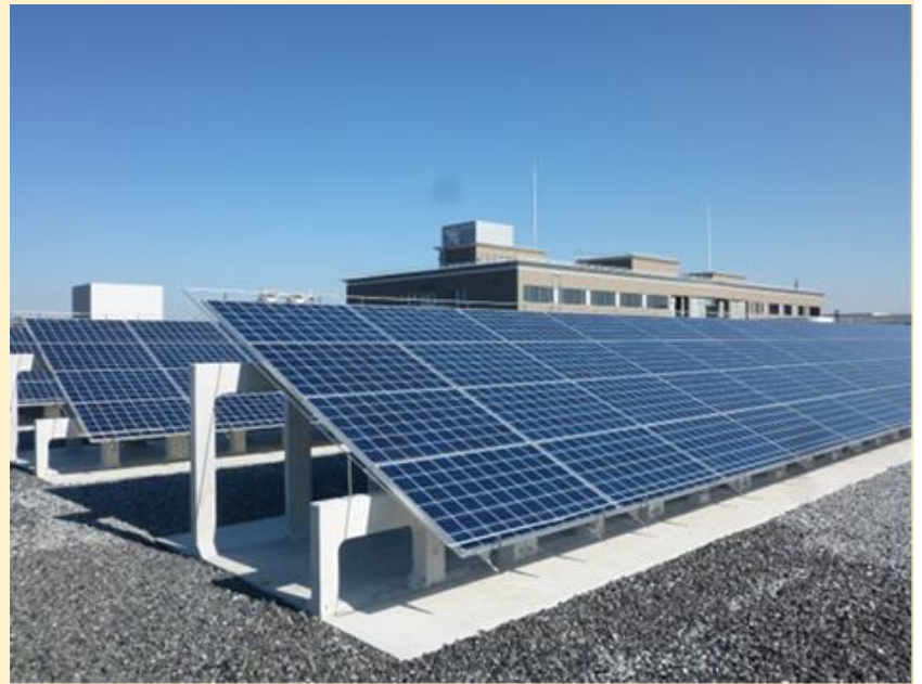
吉見浄水場 太陽光発電設備
