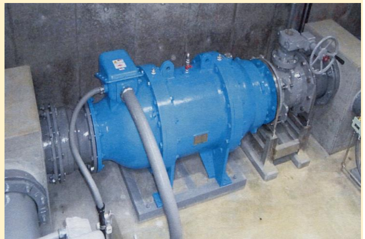
高坂中継ポンプ所 小水力発電設備
