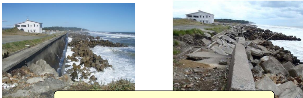
担当の山田浜地区 被災前後 堤防が崩壊
