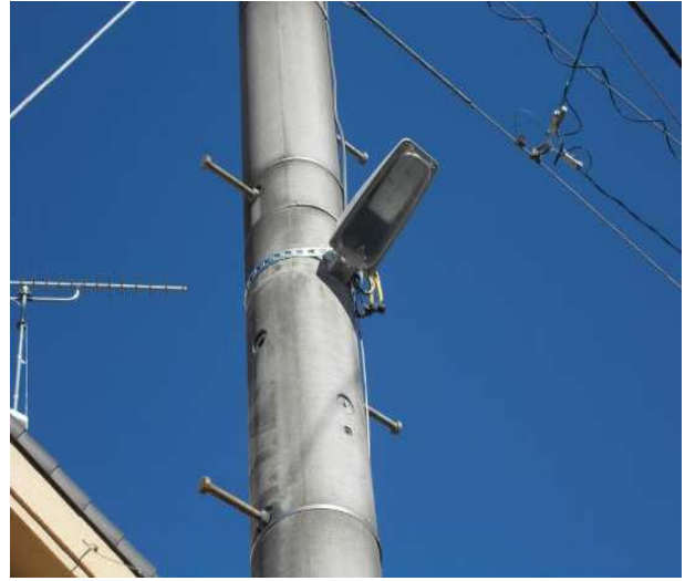
【 防犯灯設置例 】
