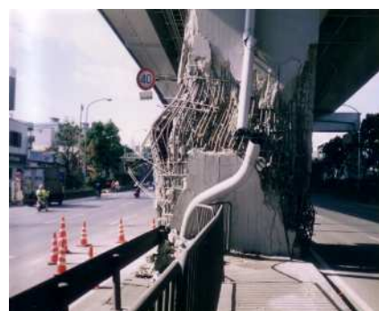
阪神・淡路大震災での損傷事例
