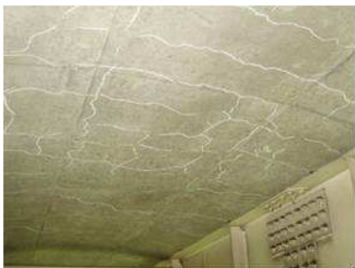
床版の劣化事例
