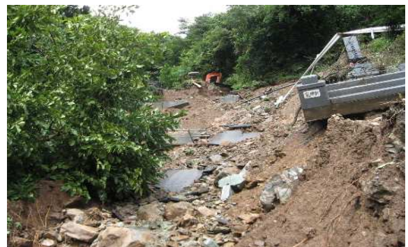
H19.9 神川町で発生した土砂災害
