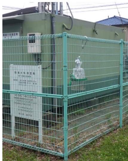
<試料採取容器設置例（常時監視局）>
