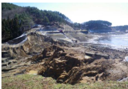
東日本大震災で決壊したため池（福島県）
