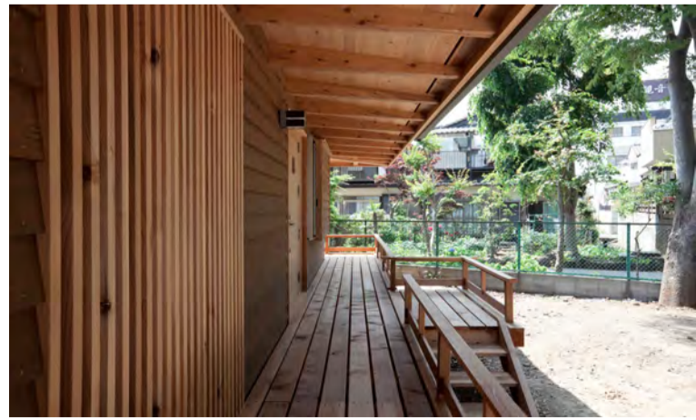
1.5m 出た軒が板の外壁と浮き回廊を守っている。木材は製造、廃棄過程でのエネルギー消費も少ない優秀な材料であるが、とにかく水に弱い。水との縁を切ることが長寿命にもつながる。
