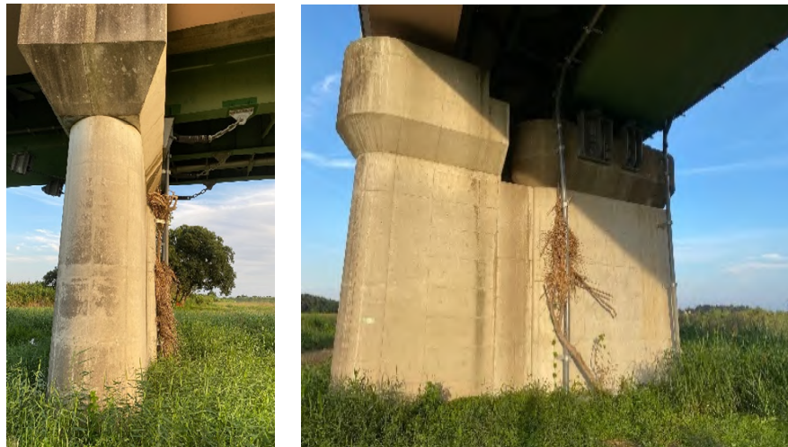
図 7.3.7 橋脚に取り付けた排水管の被災例
