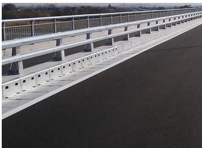
鋼製排水溝の設置例
