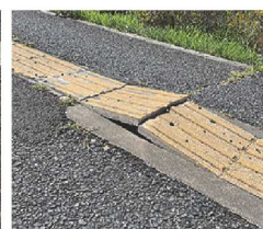
点字ブロックの剥離
