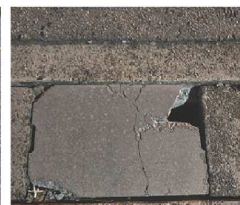
側溝蓋の破損
