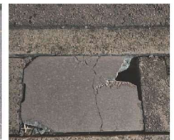
側溝蓋の破損
