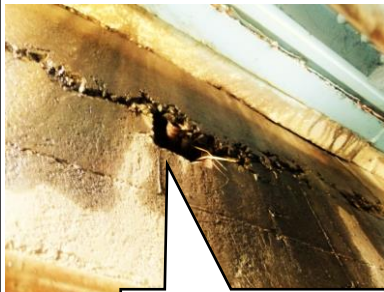
橋台のひび割れ
