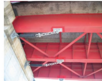
落橋防止装置
