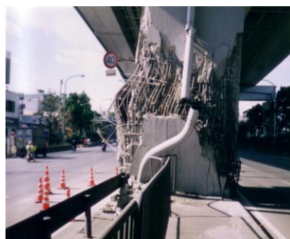
阪神・淡路大震災での損傷事例
