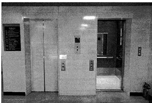
埼玉会館昇降機
