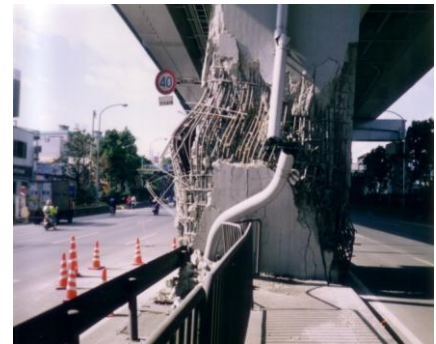
阪神・淡路大震災での損傷事例
