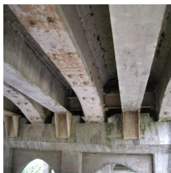
（修繕 桁の劣化）
