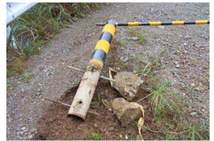
車で引き倒されたゲート
