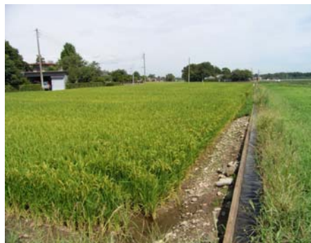
用水路の老朽化状況
