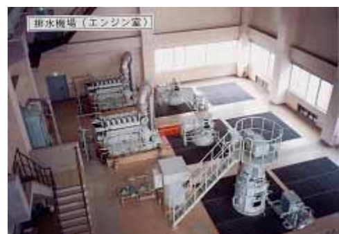
【写真9】排水機場エンジン室（事業実施後）
