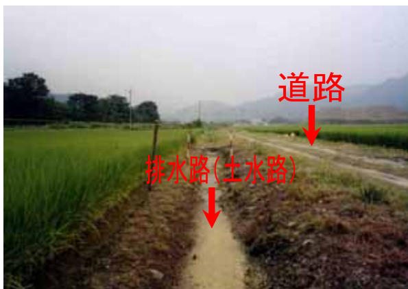
【写真】 排水路は土水路のため、法面の崩壊、雑草の繁茂等により維持管理に労力がかかる。
