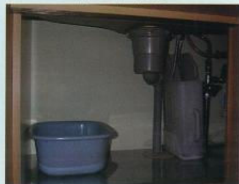
流しの下（配管）
