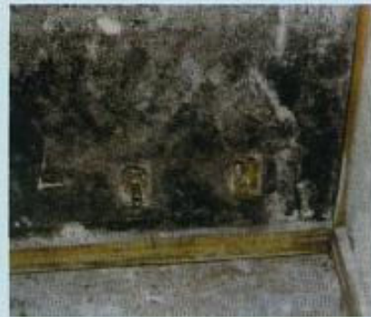
壁（内部結露によるカビの発生）
