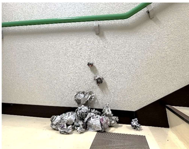
壁の破損の想定
