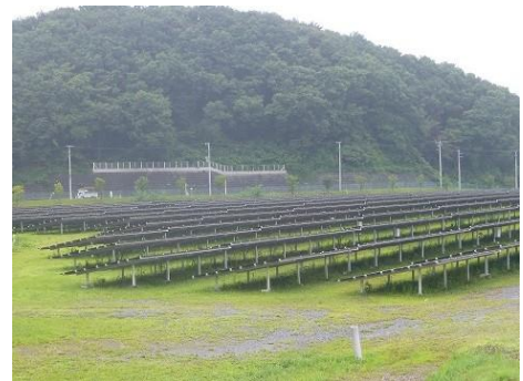
写真 太陽光発電による埋立跡地利用
