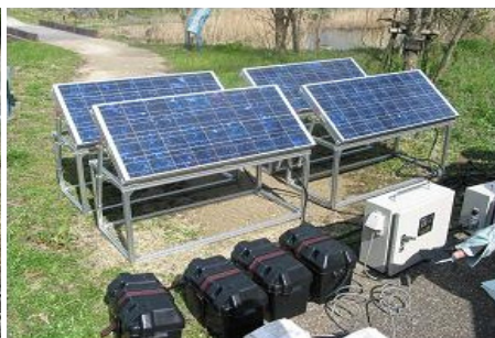
写真2 太陽光発電システム
