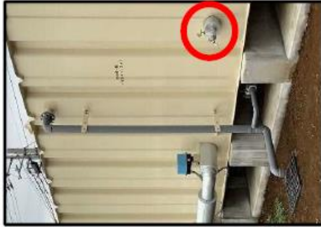
【受水槽の蛇口の例】
