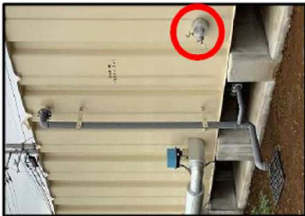
【受水槽の蛇口の例】
