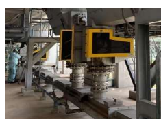
燃烧灰の移送
