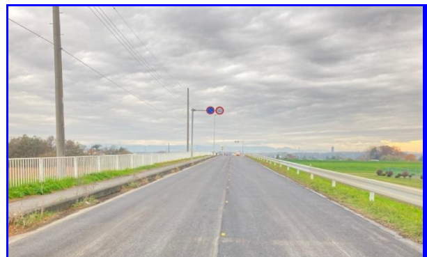
施工後 (右車線 50℃低減中温化改質Ⅱ型混合物) (左車線 通常改質Ⅱ型混合物)
