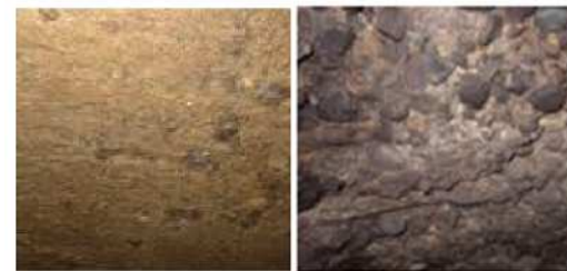
pH:7.4, \text{SO}_4^{2-} :0.01%未満 pH:2.3, \text{SO}_4^{2-} :0.15% 写真 コンクリート表面の劣化状況
