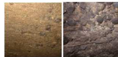
写真 コンクリート表面の劣化状況
