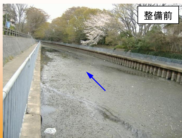
河床にヘドロが堆積している (H20.4撮影)
