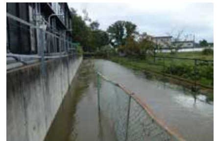
▲地盤沈下により水路護岸が下がり、住宅の基礎部まで越水した様子
