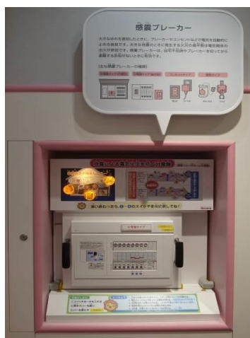
埼玉県防災学習センターでの 展示状況(分電盤型)
