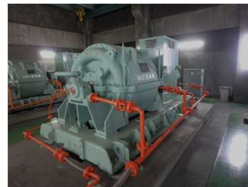
新河岸川上流水循環センター 送風機機械設備
