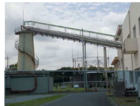
古利根川水循環センター 汚泥搬送機械設備
