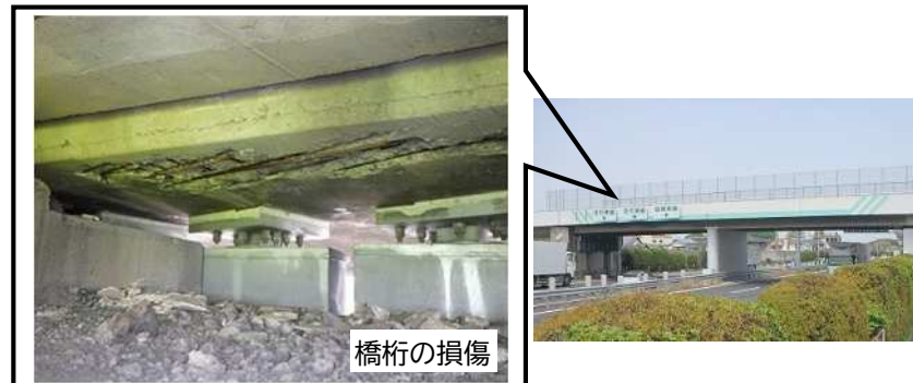
劣化状況事例
