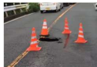
道路の陥没事例
