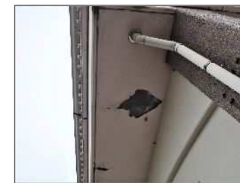
軒天の剥がれ
