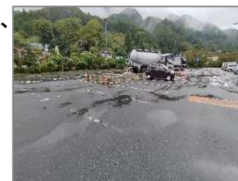
駐車場舗装の損傷
